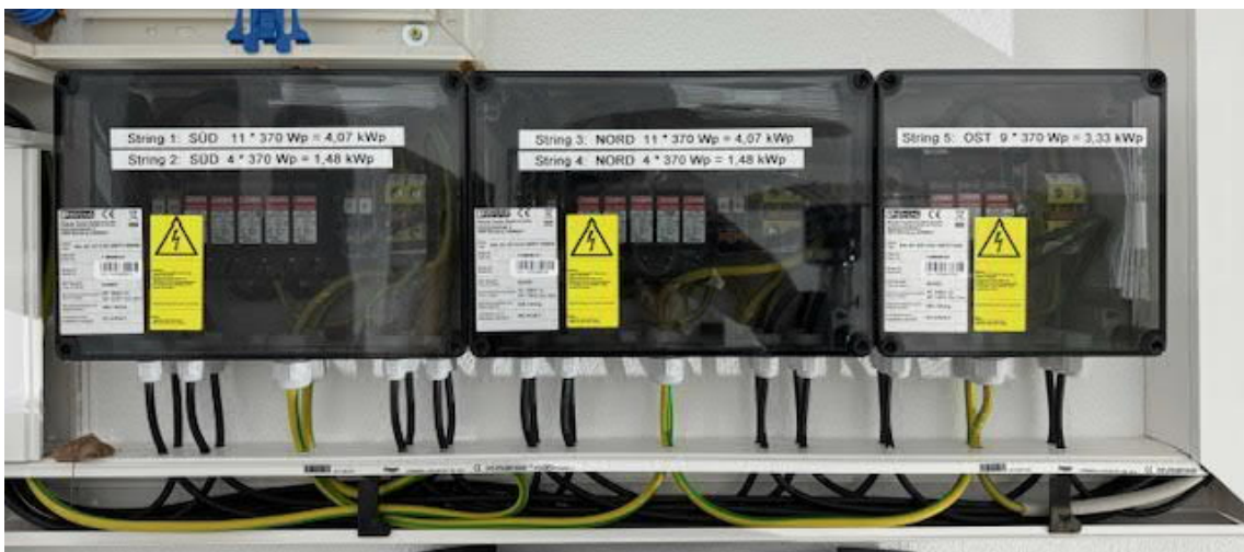
Abbildung 16: Generatoranschlusskästen String 1 bis String 5 (Quelle: eigenes Foto)
